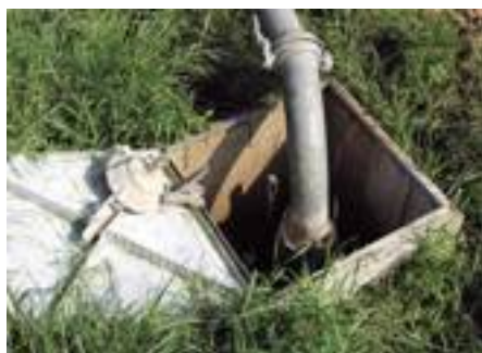
▲ Pozzetto di pescaggio che viene raccordato all'irrigatore in prossimità del campo che deve essere liquamato.
